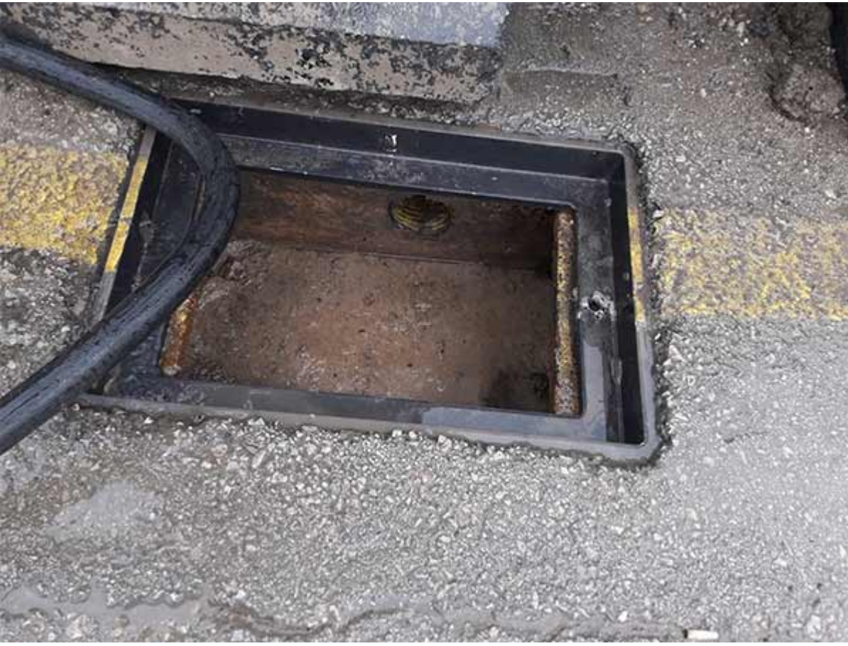
Kanal Tıkanıklığı Açma 9. Aşama
