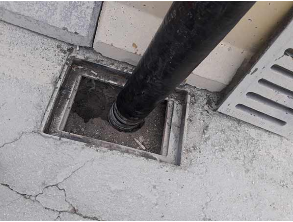
Kanal Tıkanıklığı Açma 6. Aşama
