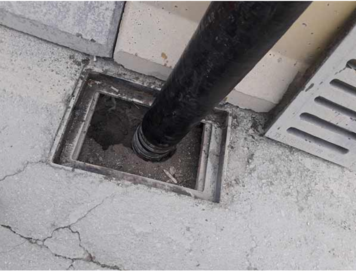
Kanal Tıkanıklığı Açma 6. Aşama
